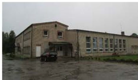
2.19. ATTĒLS: Pašvaldības ēka ar augstu īpatnējo siltumenerģijas patēriņu – Biržu tautas nams, kas apkurina arī bibliotēju pamatskolu un PII (252 kWh/m² vidēji visām šīm ēkām)
