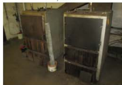
2.11. ATTĒLS: Sēlpils pagasta pārvaldes ēkas malkas apkures katli: 0,2 MW (2011. g.) un 0,23 MW (2013. g.)
