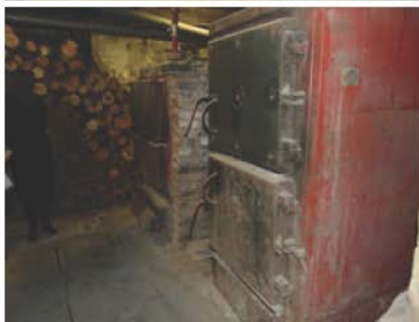
2.11. ATTĒLS: Dabas gāzes katli Uzvaras vidusskolā (augšā) un Codes pamatskola ar malkas katlu māju (lejā)
